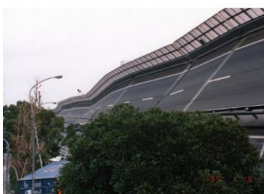
倒壊した阪神高速道路
