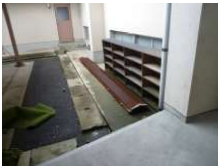
台風被害 飛んだ武道場の屋根
