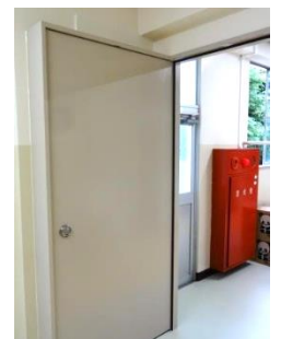
新しくなった防火シャッター
